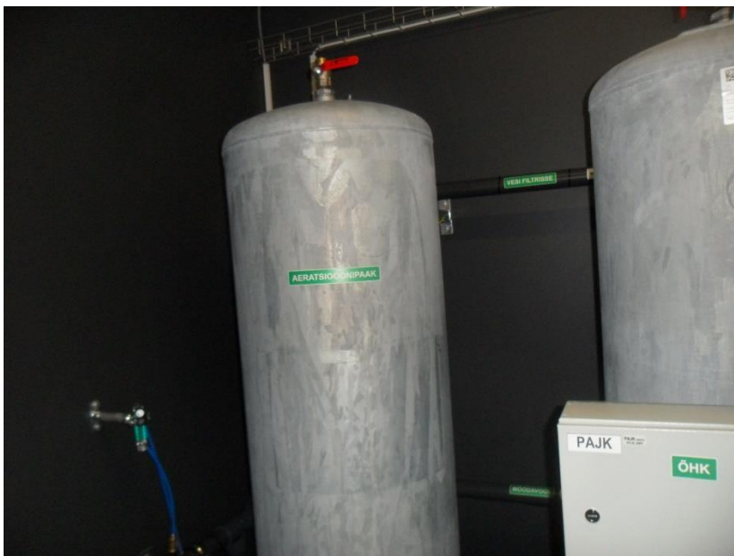
Joonis 4-17 Kohala puurkaevpumpla sisevaade, aeratsioonipaak
