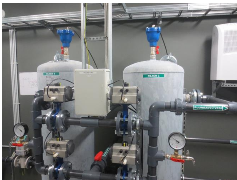
Joonis 4-11 Veltsi pumpla sisevaade, survefiltrid varustatud aeratsioonimikseriga
