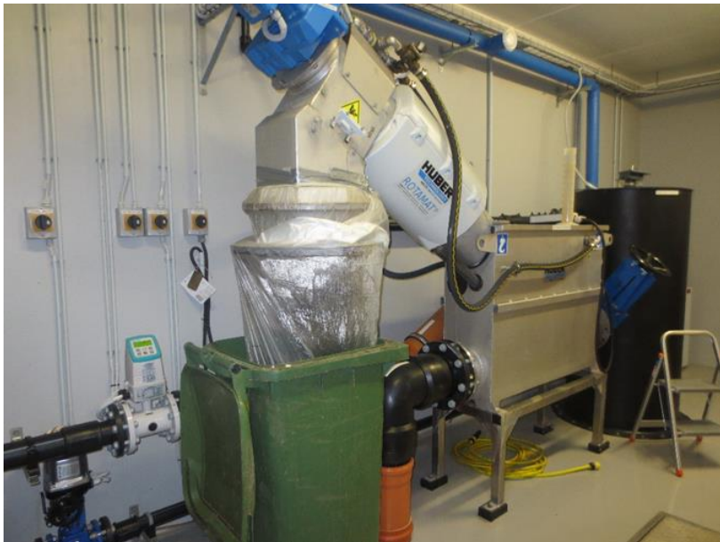
Joonis 5-4 Reoveepuhasti sisevaade (esiplaanil automaatvõreseade, tagapool vastuvõtumahuti)
