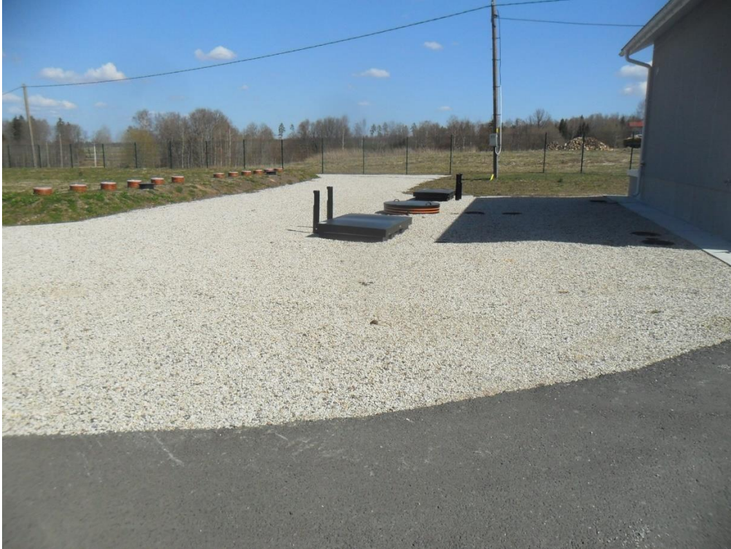
Joonis 5-19 Esiplaanil reovee peapumpla, järgneb järelpuhastusfilter ja heitveepumpla. Vasakul näha osa imbväljakust
