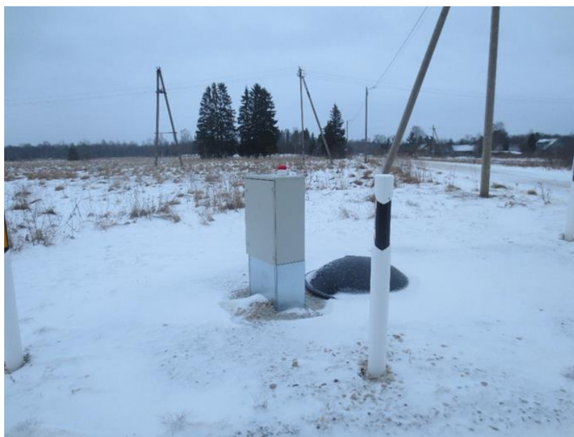
Joonis 4-9 Spetsiaalselt uhtevee ühiskanalisatsiooni pumpamiseks rajatud ajutine reovee kompaktpumpla
