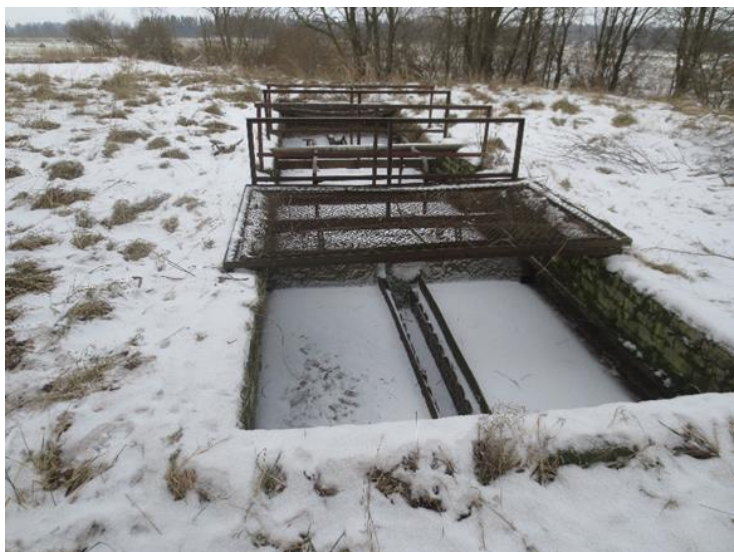
Joonis 5-11 Amortiseerunud ning talvel jäätunud ja tööst väljas Vaeküla reoveepuhasti BIO-50
