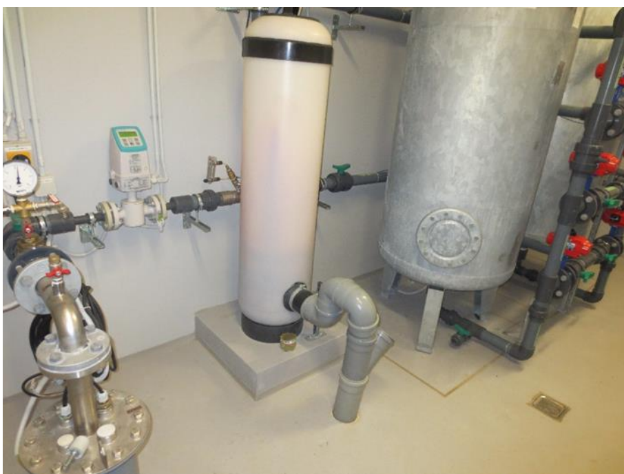
Joonis 4-6 Pumpla sisevaade, vasakul rekonstrueeritud puurkaevu päis, edasi uhteveemahuti ja veetöötlus(paaris)filtrid
